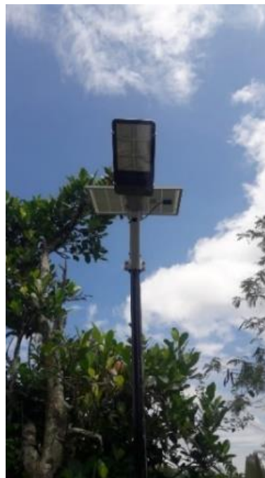
Gambar 3. Lampu sel surya yang telah terpasang. Posisi panel sel surya yang dipasang menghadap ke sumber cahaya matahari
