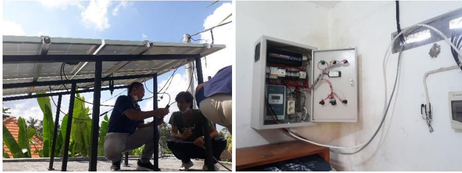
Gambar 1. Eksisting Pemasangan PLTS di Villa De Lod Ubud
